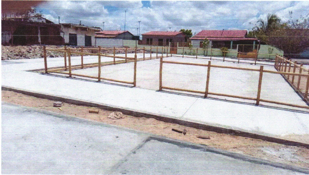
Foto 05- FORNECIMENTO E MONTAGEM DE CERCA DE PROTEÇÃO EM EUCALIPTO CLOEZIANA TRATADO A BASE DE CCA EM AUTOCLAVE, COM APLICAÇÃO DE STAIN NA COR NATURAL COM DUPLO FILTRO SOLAR, DIAMETRO DO EUCALIPTO DE 6 A 8 CM, COM ANTI-RACHA NA EXTREMIDADE. FECHAMENTO COM TELA DE ALAMBRADO FIO Nº 12 REVESTIDO DE PVC, MALHA 2.1/2 X 2.1/2", FIXADO COM FIO Nº 14 REVESTIDO EM PVC, MÓDULO MEDINDO 1,50 X 1,00M, PARAFUSOS GALVANIZADOS COM TRAVAMENTO CLICKFIX, CONFORME PROJETO
