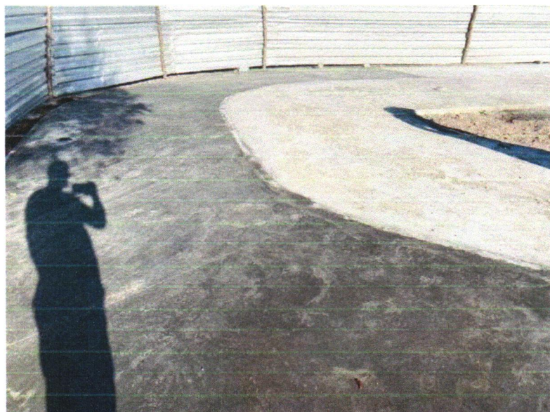
Foto 02 – PAVIMENTAÇÃO EM CONCRETO, COM ESPESSURA DE 7 CM, COM ACABAMENTO FEITO UTILIZANDO ALISADORA DE CONCRETO (HELICOPTERO), INCLUIDO TELA DE AÇO SOLDADA NERVURADA CA60, Q196 (3,11 KG/M2), DIAMETRO DO FIO 5.0 MM, LARGURA = 2,45 M, ESPAÇAMENTO DA MALHA = 10 X 10 CM, JUNTA DE DILATAÇÃO EM PVC A CADA 2,00 M, CONCRETO FCK = 20 MPA
